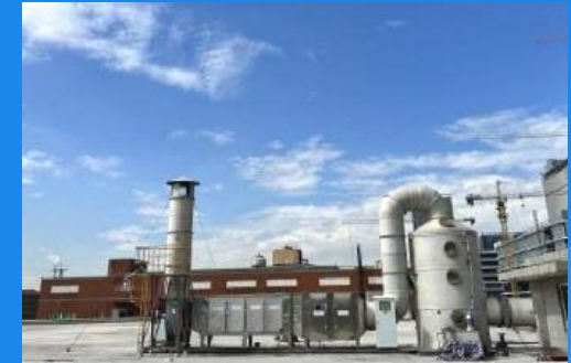
公司治理 VOCs減排裝置
